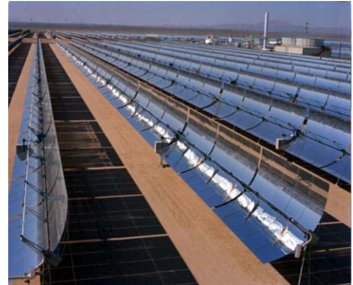
Parabolrinnenkollektoren für 400°C
